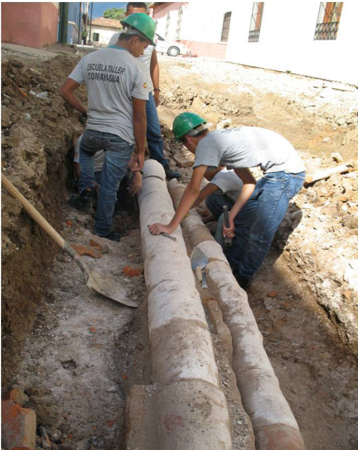
Imagen7 Cañerías hechas de barro cocido encontradas en la ciudad de Comayagua, manifiestan la misma técnica de construcción que las de Guatemala y el resto de la América Hispánica.
