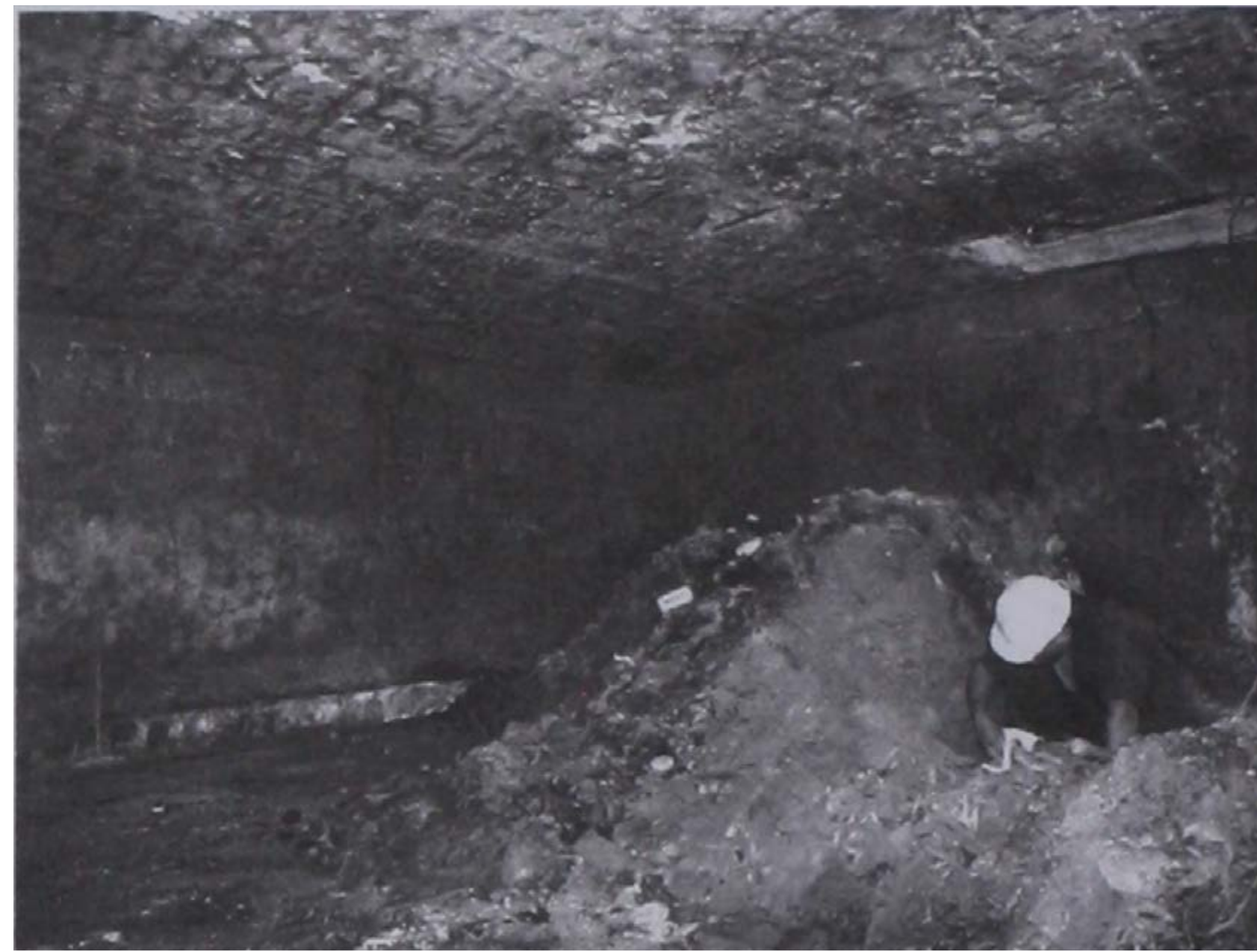
Imagen 20. Caja de registro de ladrillo y tubería de concreto de los años 40 y la parte baja drenaje de piedra labrada de finales del S. XIX. (foto de José Roberto Ramírez Torres, IHAH).
