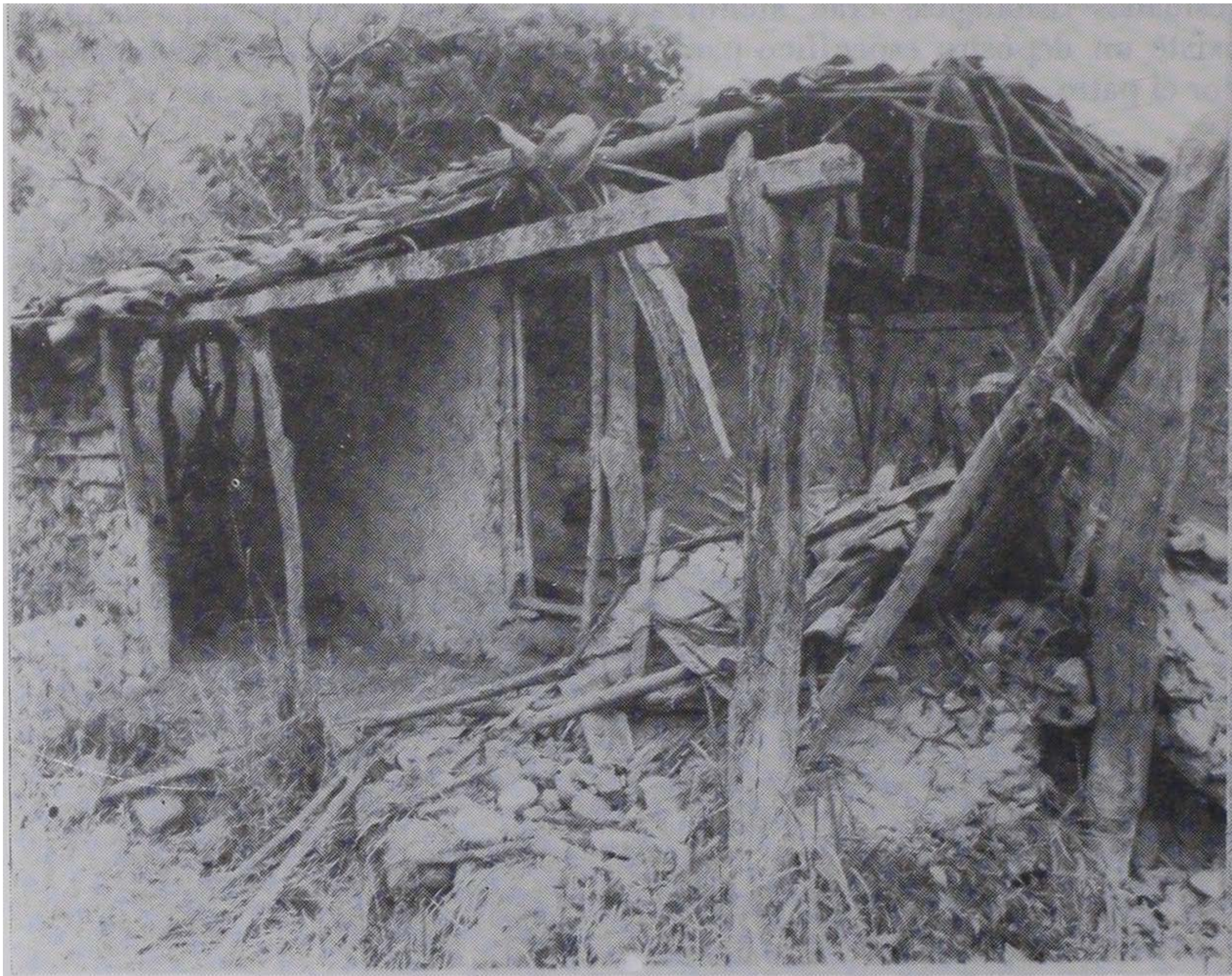
Fig. 8 Deterioro de la casa
